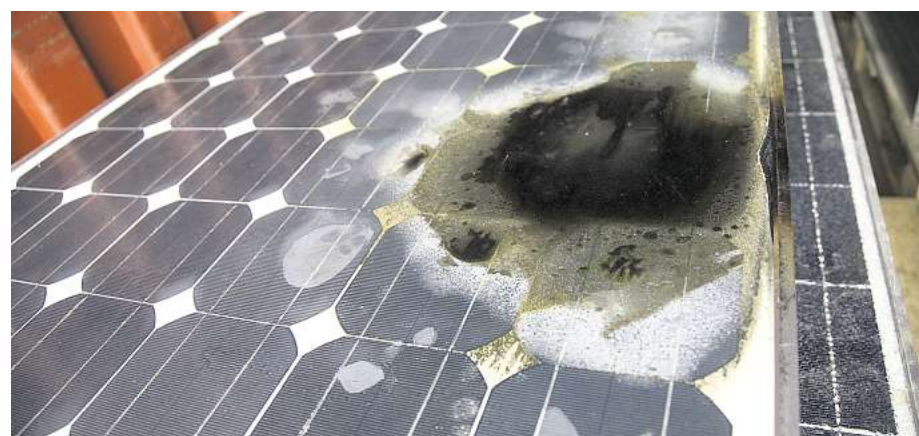
Defekte Module aller Art kommen in der Freiburger Recycling-Fabrik an. An diesem Modul ist der Brandschaden deutlich zu erkennen. Andere wurden durch Hagelschlag, Stürme und Schneebruch oder bei Transport und Installation zerstört.
